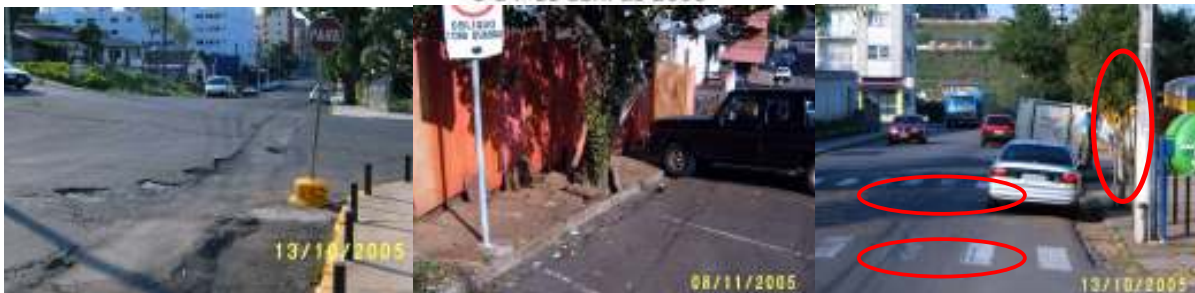
Figura 8: Defeitos no pavimento, calçadas e sinalização urbana.
