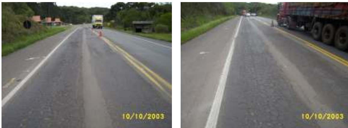
Figura 2 – Trilhas de roda completamente trincadas
